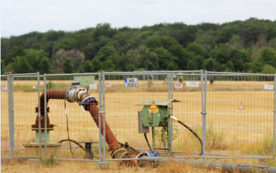
Die Sumpfungspumpen haben den Grundwasserspiegel schon seit Jahrzehnten abgesenkt. Der Wald überlebte bislang dank der Niederschläge und der Wasserhaltefähigkeit der Böden.
