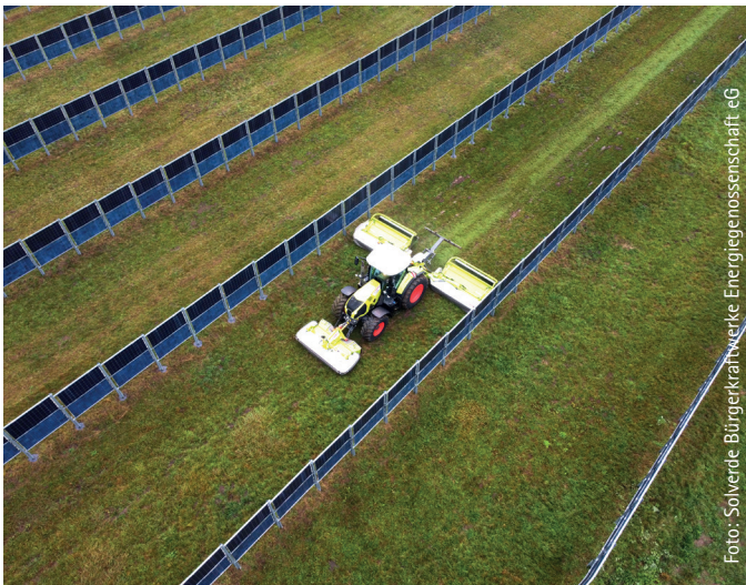
Vertikal errichtete, bifaziale Module im Solarpark Donaueschingen.
