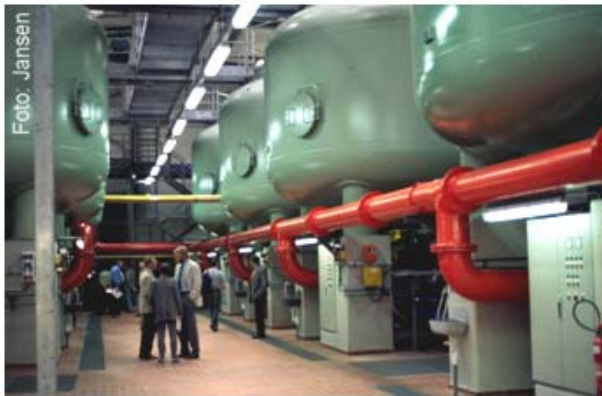
Wasseraufbereitungsanlage bei Jüchen
